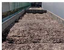
縦型コンポスト脱臭槽
